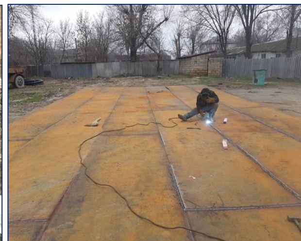
Водоснабжение г. Южно-Сухокумск 2023-2024
